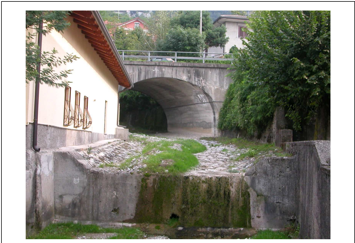
Foto n.5 – Punto critico in prossimità delle scuole elementari, con argini bassi in sponda sinistra
