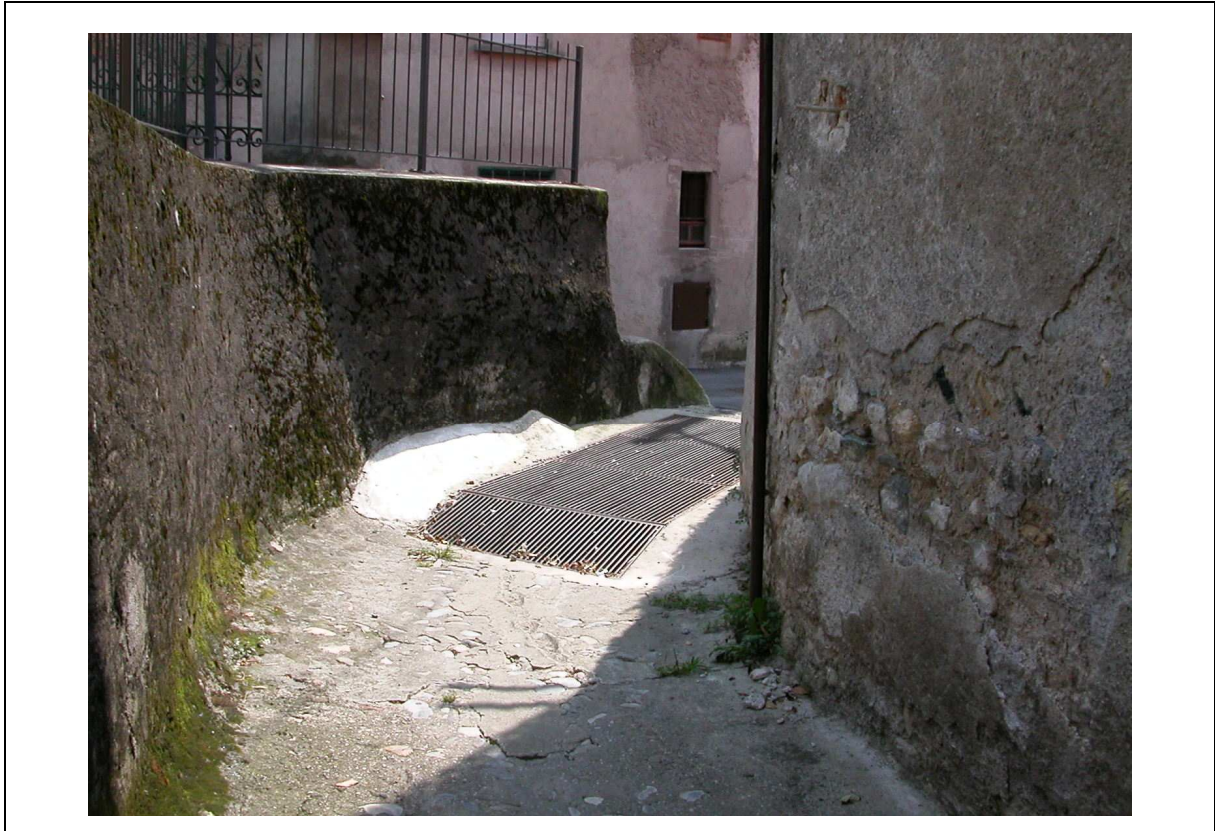
Foto n.12 – Griglia di convogliamento delle acque in tubazione interrata nel centro abitato a monte della SS639
