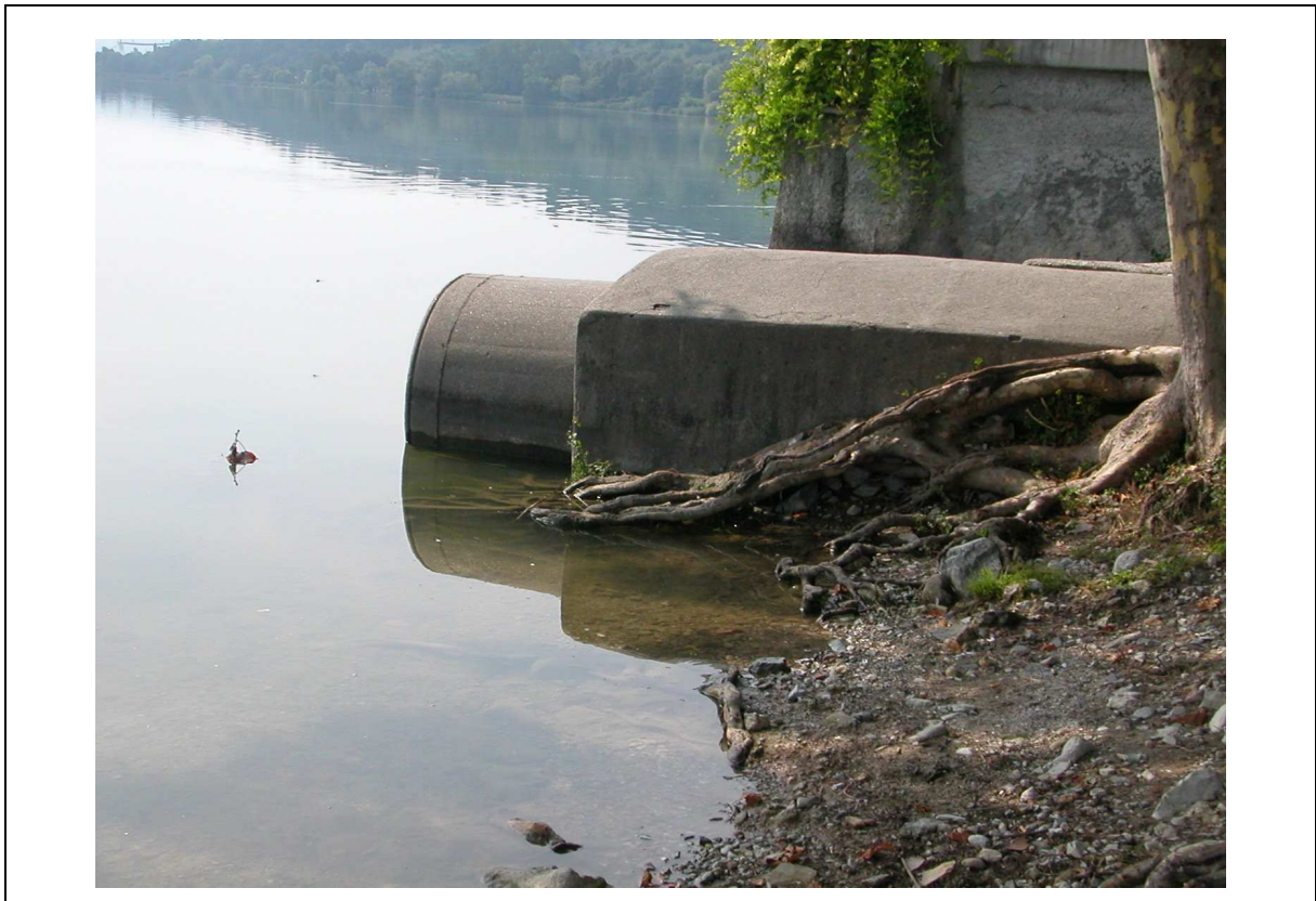
Foto n.13 – Sbocco a lago camicia in calcestruzzo diametro 100cm
